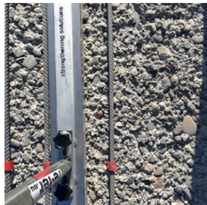
4 Aktivieren «Erhitzen» von re-bar mit Infrarot-Heizstrahler re-IR 1500
