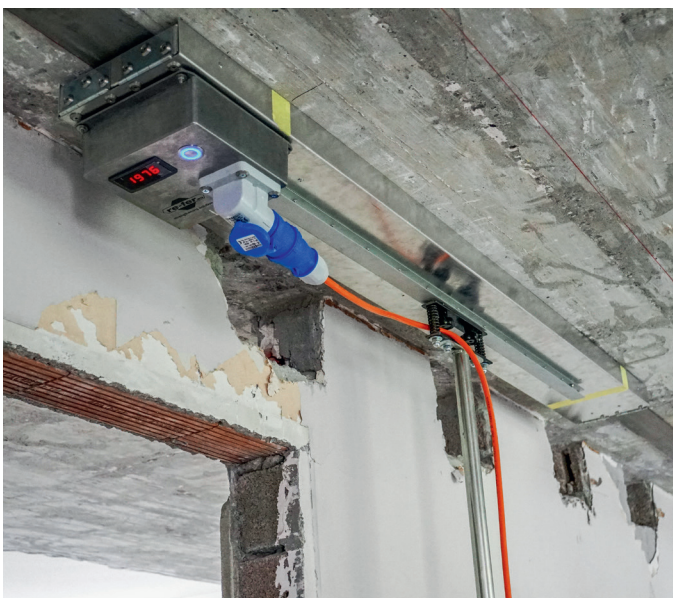
Eine Temperaturanzeige ermöglicht die Überwachung des Heizvorgangs auf über 160 Grad Celsius.
