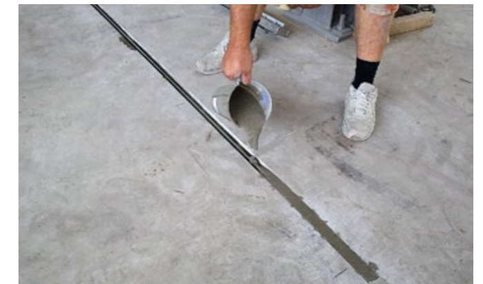
5 Scellement de re-bar avec SikaGrout-311 entre les deux côtés des extrémités d'ancrage
