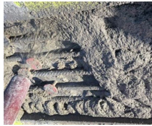
3B Inbedding aan beide zijden in Sika MonoTop-422 PCC «gespoten mortel» als eindverankering"
