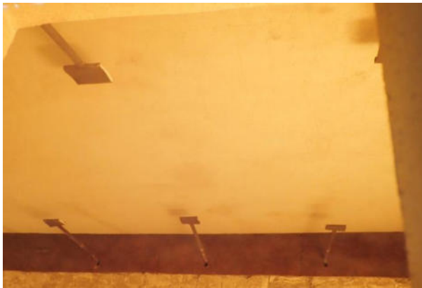
Bild A3.13 Beginnende Rissbildung (20. Prüfminute)
